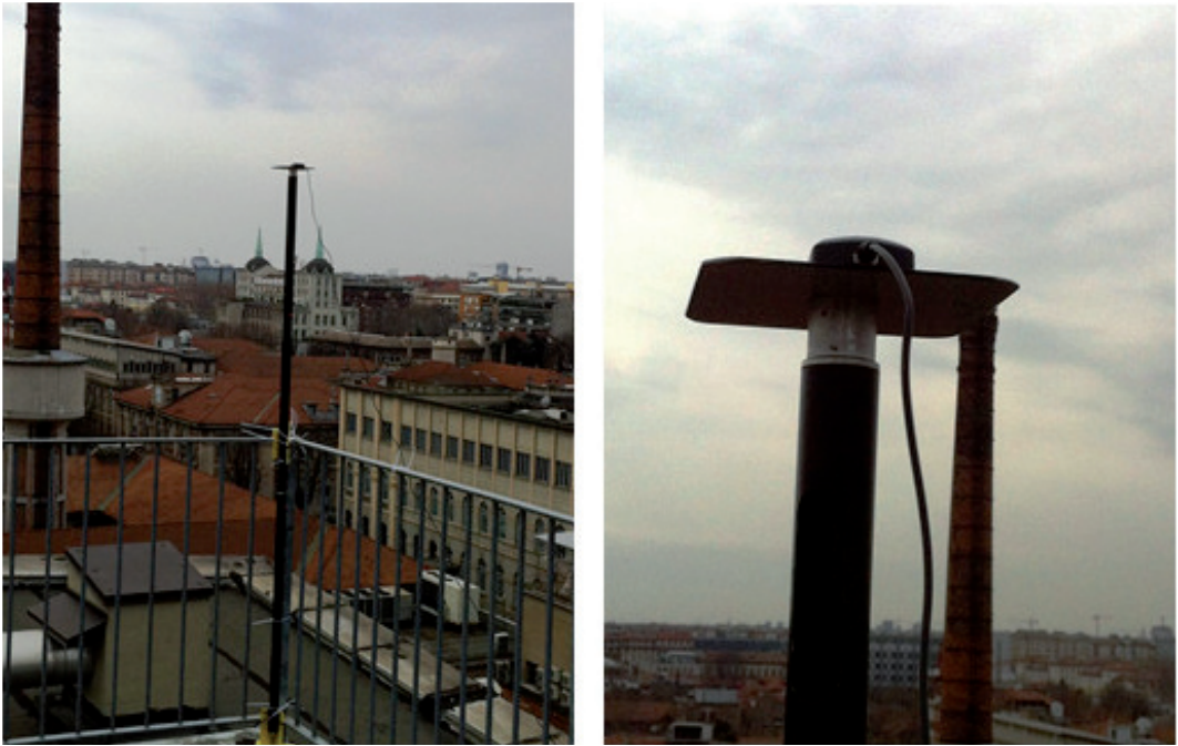
Fig. 1 – Installazione dell’antenna ANN-MS del ricevitore u-blox EVK-6T sul tetto dell’edificio Nave (a sinistra) e dettaglio della basetta metallica usata come sostegno per il fissaggio dell’antenna (a destra).
